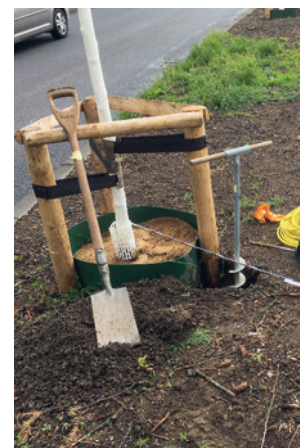
Abb. 4: Einbau der Sensoren an fünf Gehölzen. Die Ausstattung in der Auswurzelungszone erfolgt in etwa 70 Zentimeter vom Stamm entfernt. Der Ballen-Sensor wird direkt im Ballen verbaut. Die Installation ist auch nach der Pflanzung problemlos möglich.
