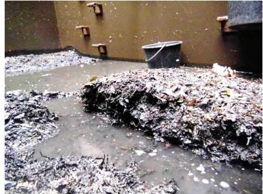
Laub- und Vegetationsreste im zulauffernen Bereich des Geschiebeschachts
